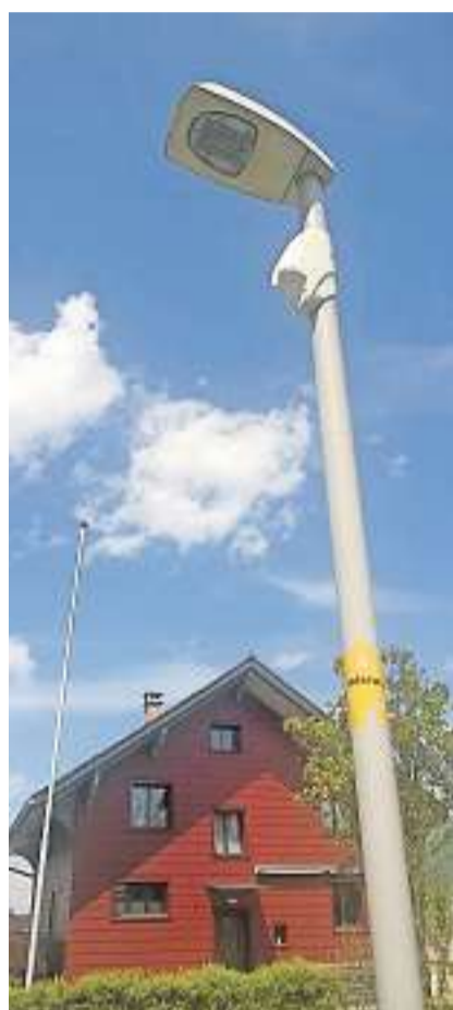
Die Strassenleuchte mit Intelligenz am Tramweg in Oberarth. Bild: zvg
